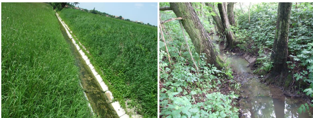
Obr. Vlevo je velmi zachovalý úsek úpravy se žlabovkami. V těchto a obdobných úsecích se navrhuje odstranění opevnění. Na snímku vpravo je zachycen úsek koryta, jehož opevnění je přerůstáno a rozrušováno stromy, čímž je urychlována jeho renaturace. Kromě vrůstání dřevin do koryta je na snímku patrné též zanesení koryta splaveninami. V těchto úsecích není vhodné opevnění odstraňovat, neboť by došlo k narušení kvalitního vegetačního doprovodu.
