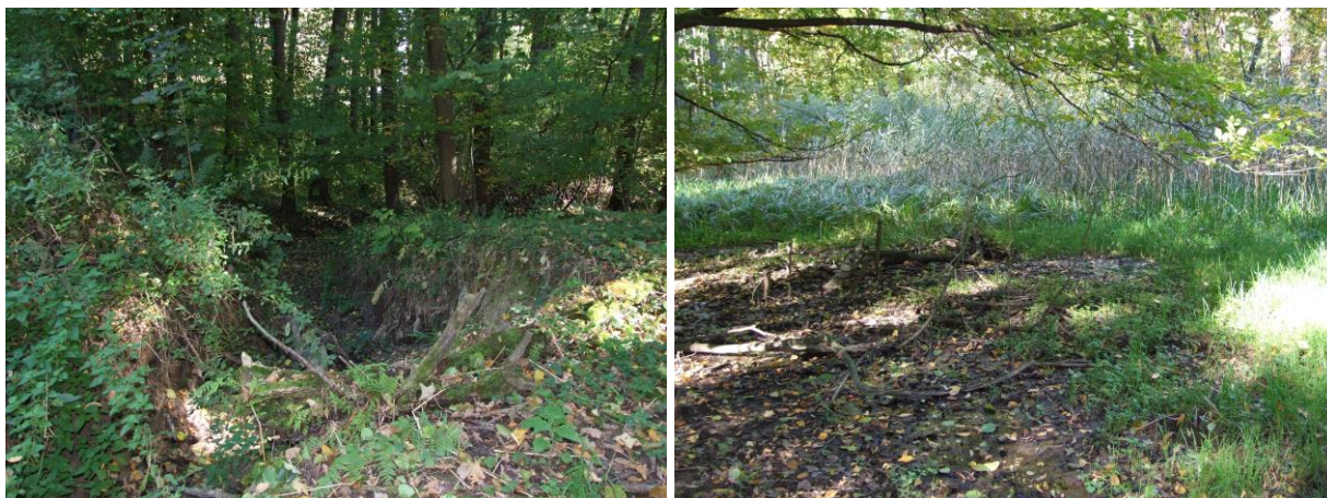
Obr. Hráz rybníka v místě jejího porušení (vlevo) a celkový pohled na zanesený prostor zátopy (vpravo).
